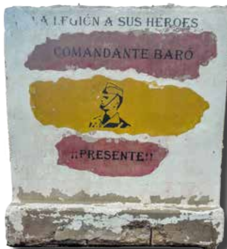
Estado actual del T-wall situado en el patio de armas del Acuartelamiento de Montejaque, Tercio 4º en Ronda.
