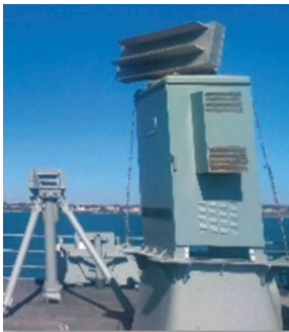
Armario electrónico y antena del radar iKeeper instalados a popa de la cubierta 2 de la fragata Santa María . (Fotografía del autor)
